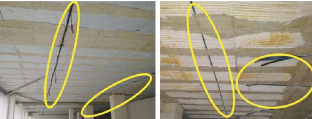
Elektrik tesisatları ve kablolarının, EPS asmolen blok ile yapılan döşemelerin alt yüzeyinden, bazı yerlerde de EPS asmolen blokların içerisinden, bir plastik boru ile geçirildiğini kanıtlayan fotoğraflar.
